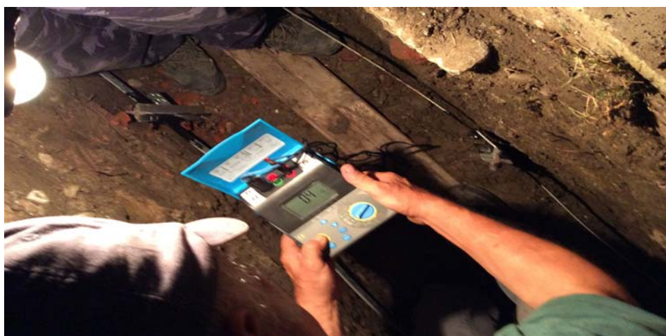
Foto nr.4. Instalație de legare la pământ-măsurarea rezistenței de dispersie în [ \Omega ]
