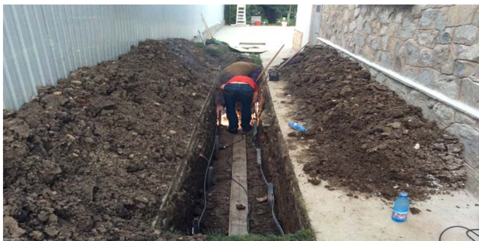
Foto nr.3. Instalație de legare la pământ cu electrozi verticali și bandă(platbandă) din O1 Zn
