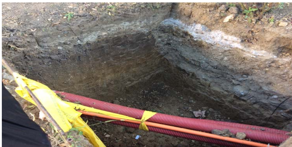
Foto nr. 2 Săpătură în sol destinată montajului unui stâlp de iluminat public
