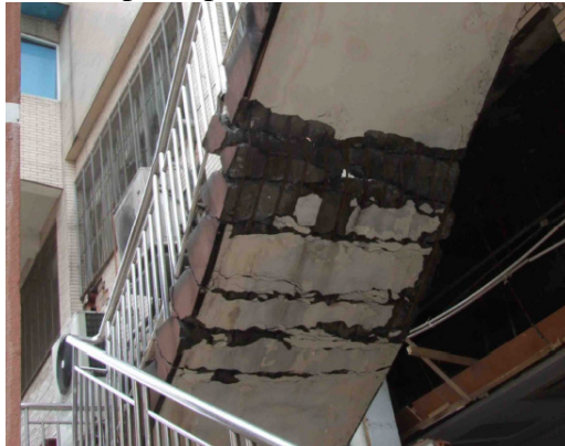
Figura 8- Încovoierea rampei – Sichuan 2008
