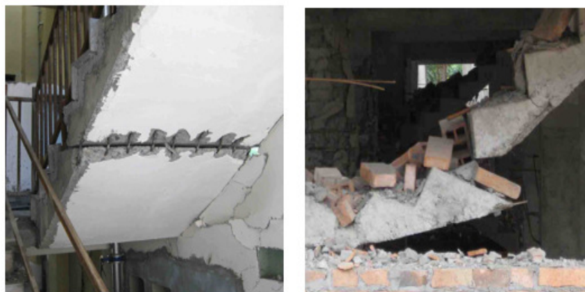
Figura 9- Forfecarea transversală a rampelor - Sichuan 2008
