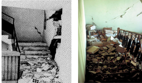
Figura 12- Distrugerea pereților incintei scării, distrugerea treptelor, deformarea balustradelor - Nicaragua 1972
