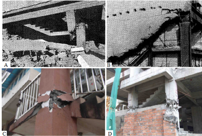
Figura 3 - Forfecarea stâlpilor (beton și metal) în vecinătatea podestului intermediar – fenomenul de „scurtare a stâlpilor” (A. El Asnam, Algeria – 1980, B. Alaska – 1960, C. și D. Sichuan, China - 2008)
