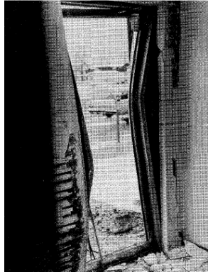
Figura 11- Deformarea golului de ușă în vecinătatea rampelor scării – Alaska 1960
