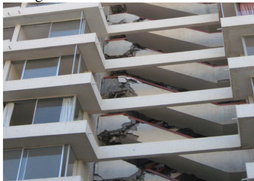
Figura 7- Scările au fost prinse rigid și au funcționat ca niște contravântuiri - Chile 2010
