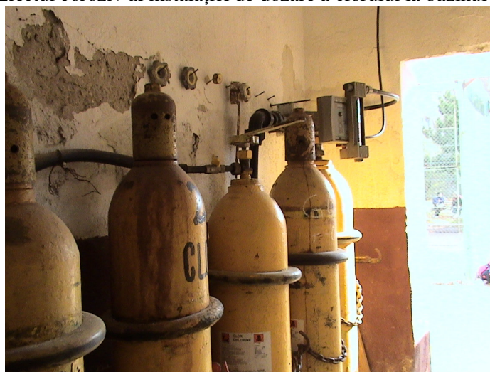
Fig. 2 - Efectul corosiv al clorului asupra construcțiilor de la bazinul de înot T 1
