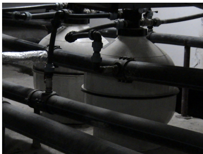
Fig. 7 – Instalația pentru limpezirea apei de la bazinul de înot T 2
