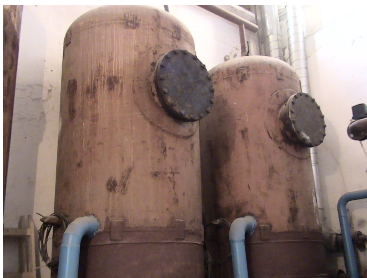
Fig. 4 - Efectul corosiv al clorului asupra instalațiilor de la bazinul de înot T 1
