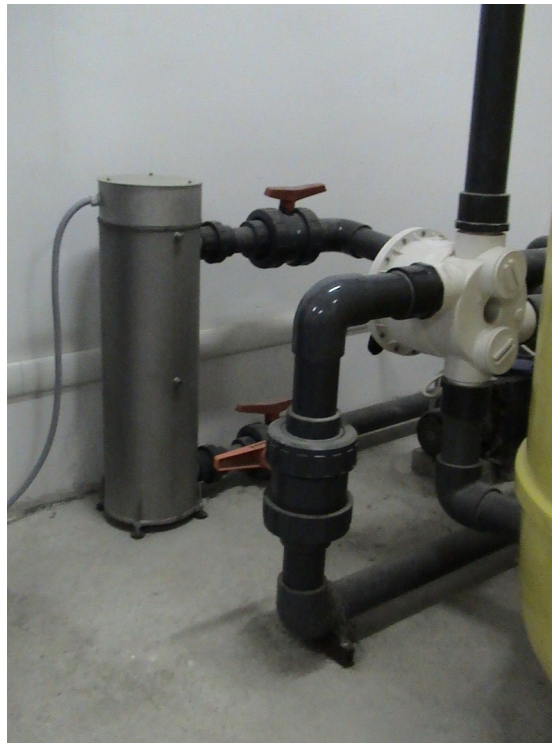
Fig. 15 – Instalația de dizinfecție cu raze ultraviolete a circuitului de alimentare la bazinele T 4 și T 5
