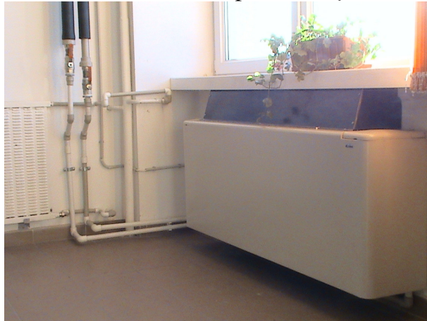
Fig.2. Ventiloconvectorul care recuperează căldura din aerul exhaustat
