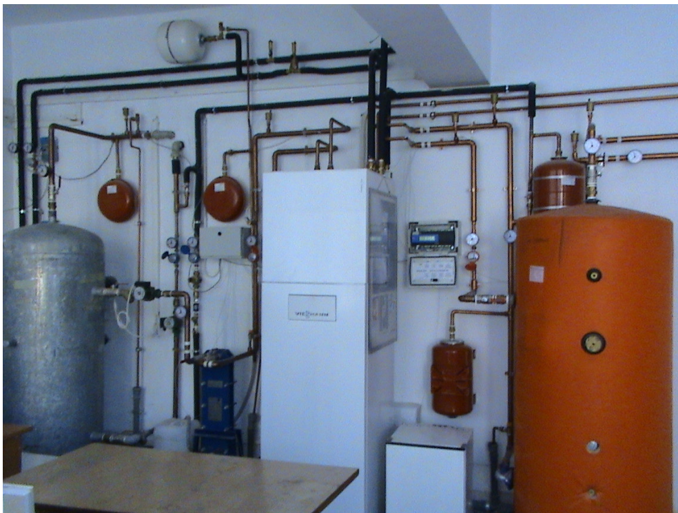
Fig.3. Pompa termică amplasată între cele două rezervoare de stocare este separată de circuitul de apă rece prin intermediul schimbătorului de căldură în plăci
