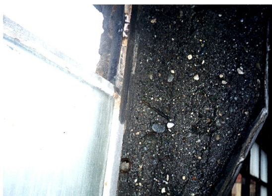
Fig. 5. Depozit de sulf – aspect consolă de capăt șir A ax 3
