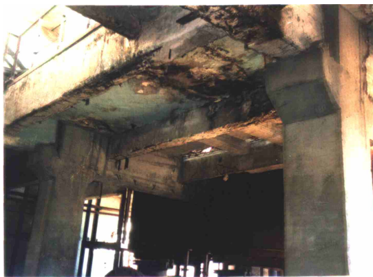
Fig. 3. Hala Intermediari “B1” – Degradarea planșeului de la cota +4,80 m, șir B – C, axele 4-5
