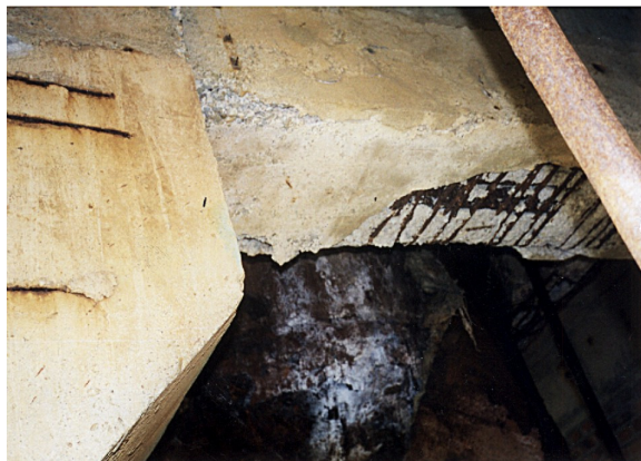
Fig. 1. Secția acid “I” – Aspect consolă și riglă de cadru șir B ax 5 cota +5,50 m
