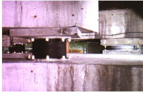
Figura 11 "Izolator din cauciuc natural montat în sit"
