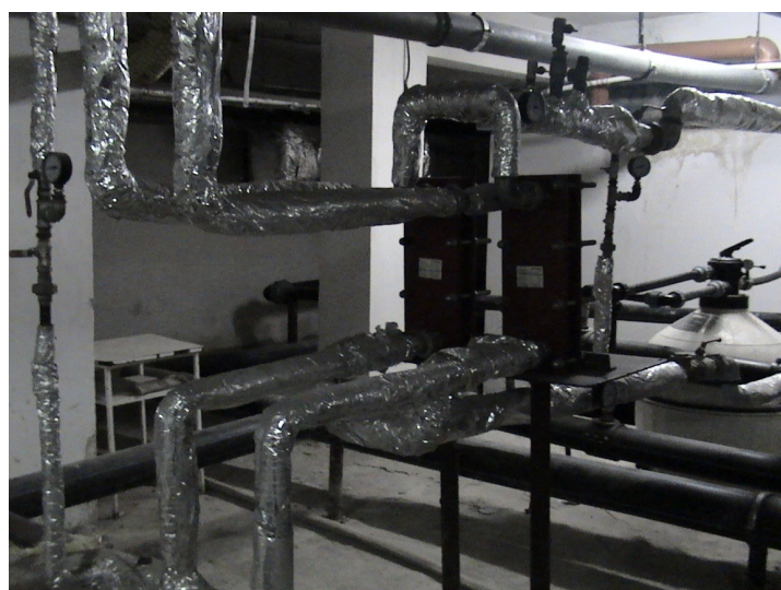
Fig. 8 – Instalațiile pentru tratarea apei de la bazinul de înot T 2
