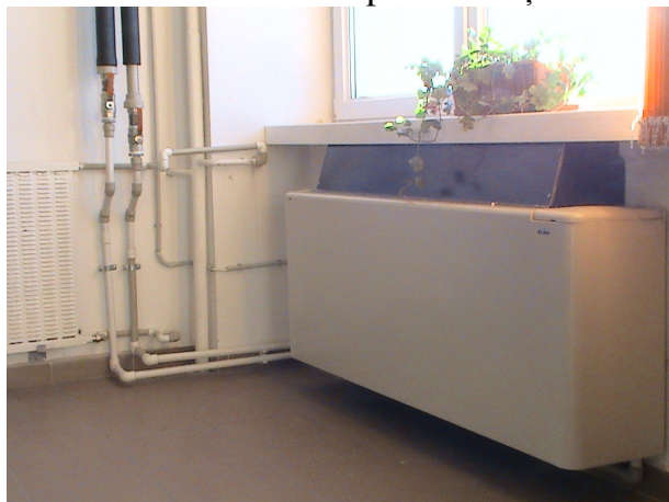
Fig.2. Ventiloconvectorul care recuperează căldura din aerul exhaustat
