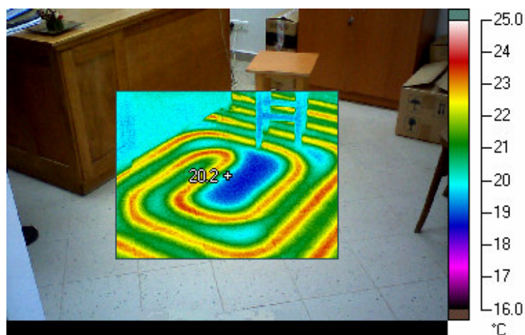
Fig.4. Imaginea termografică a circuitului de distribuție a căldurii amplasat în pardoseala laboratorului de la subsolul clădirii
