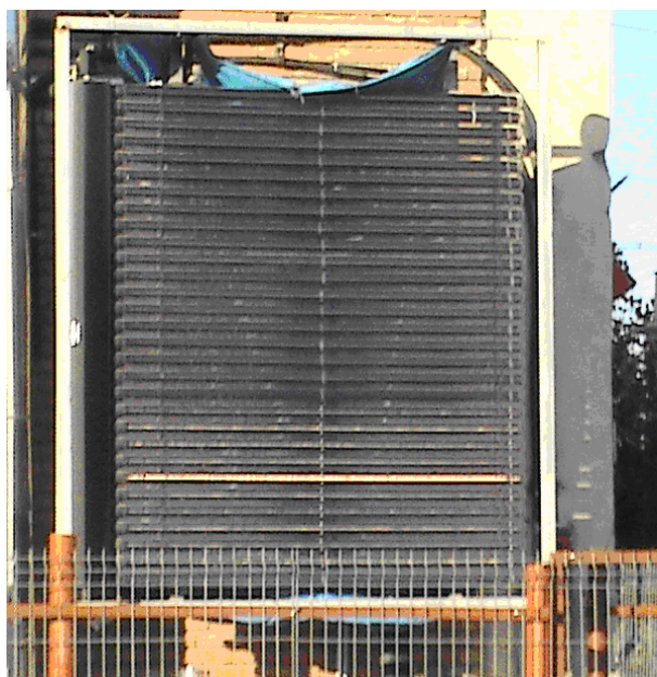
Fig.5. Panoul solar amplasat pe peretele sudic al clădirii
