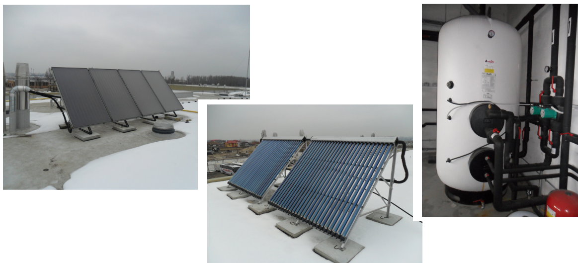
Fig.2 . Panourile solare și rezervorul de acumulare a apei calde
