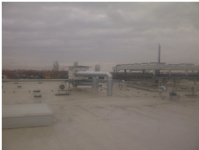
Fig. 1. Recuperatorul de căldură pentru aerul evacuat din birouri.
