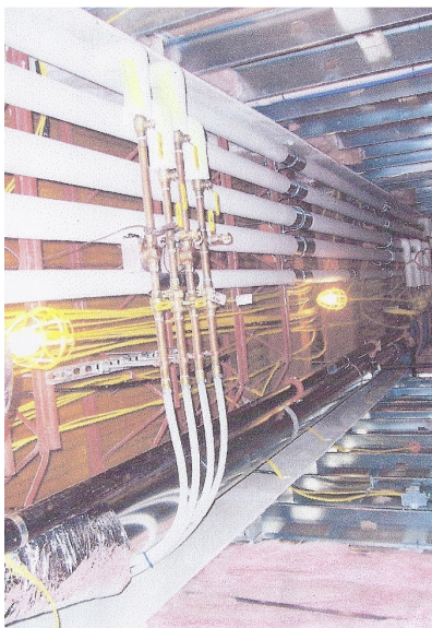
Fig. 3. Reteaua de conducte de incalzire, apa rece, apa calda menajera si cablurile electrice la plafonul coridorului
